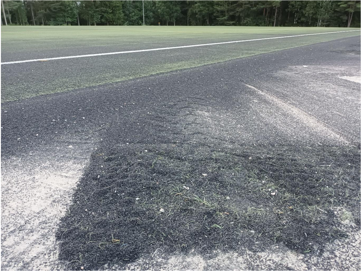
Kuva 5-7. Kumirouhetta ja irronnutta nukkalankaa kulkeutuu kunnossapitotöissä helposti tekonurmikentän ulkopuolelle, josta sitä on vaikeaa kerätä talteen.
