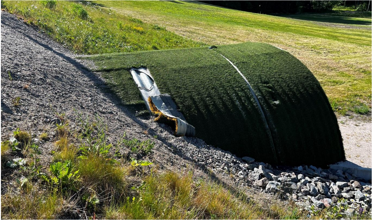
Kuva 8-8. Vantaan Hakunilan urheilupuistossa alikulun rumpu on verhoiltu käytetyllä tekonurmella. Liimaukset eivät kuitenkaan ole kestäneet kovin hyvin.
