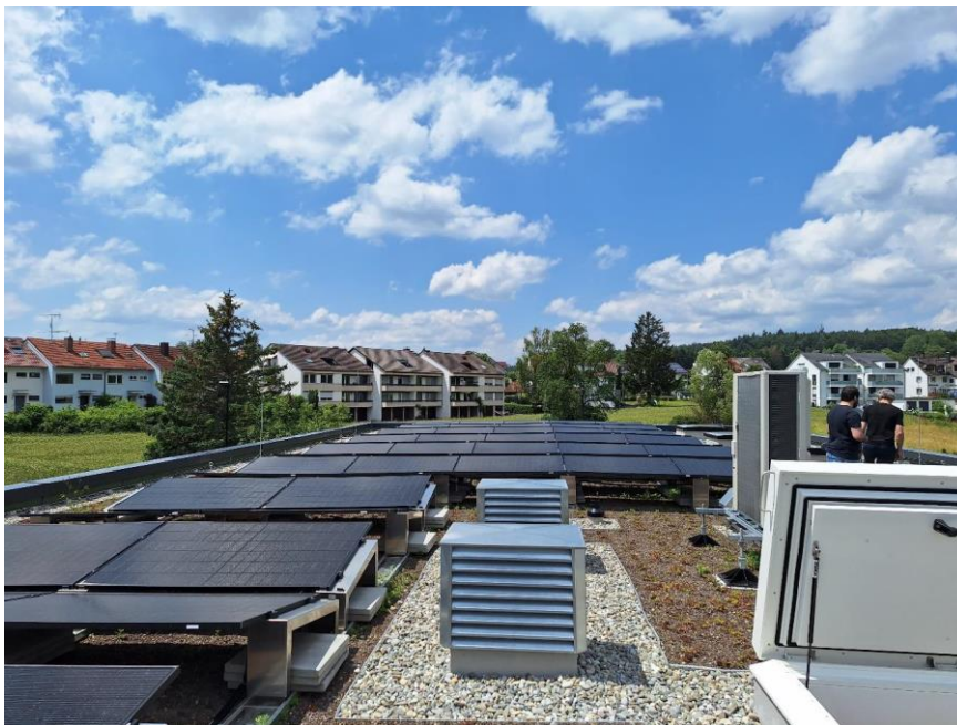
Abbildung 10: PV-Anlage auf dem Neubau des Feuerwehrgebäudes Dettingen
